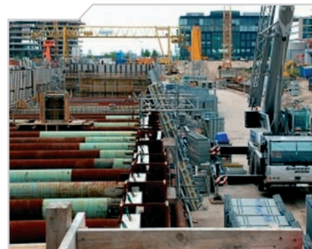
Typische Anwendung von WSM1 zur Messung von Baugrubenaussteifungen
